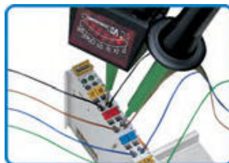
Проверка прохождения сигнала при подсоединенных проводниках
